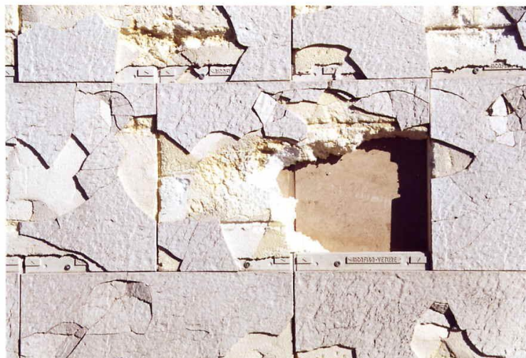
Dégradation de l'isolation extérieure et du parement
