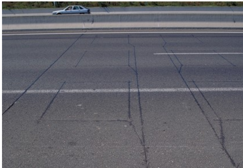
Figure 6 : Les boucles électromagnétiques dans la chaussée (source MEDDE)
