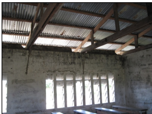
Photo 59. Les murs sont également en mauvais état mais le toit a été reconstruit récemment (l'état de la charpente et des tôles en atteste) :
