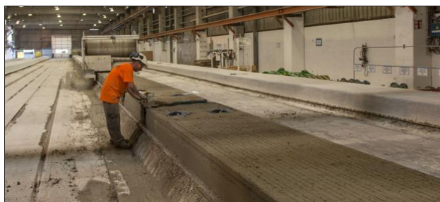
■ Un salarié sur l'un des trois bancs de dalles alvéolées du site de Ciel. Photo DR
