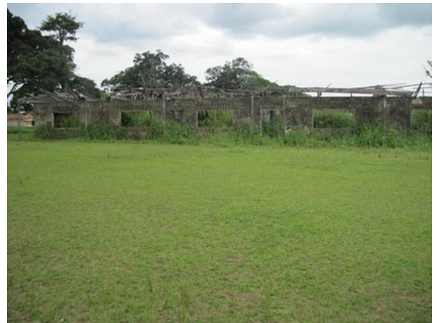
Photo 48 : Collège de Kindamba : l'internat détruit.
