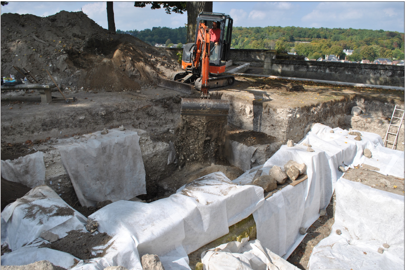
Figure 12 : Vue du rebouchage de la fouille, avec protection des vestiges par du géotextile
