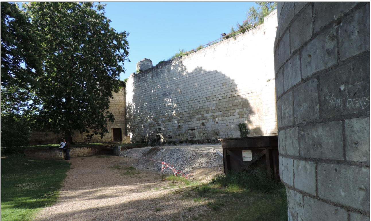
Fig. 5 : Vue des lieux après démontage de la scène et avant les terrassements : à droite au premier plan, l'ancien caisson électrique à enfouir, au pied de la tour « Philippe Auguste »
