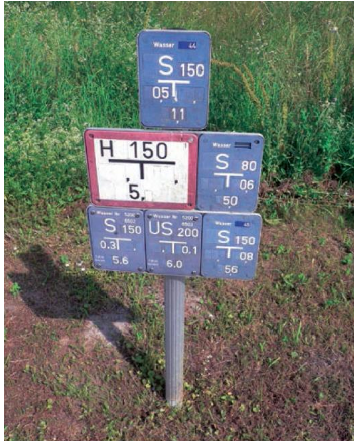
Le réseau d'eau à découvert : plaques indiquant les vannes et poteau d'incendie à Magdeburg (Allemagne). © D. FLORENTIN, 2013. ■
