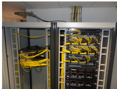
Figure 6: Cœur de réseau : en haut arrivée et départ des 3 boucles optiques, à droite les 432 ports LC, à gauche la partie active
