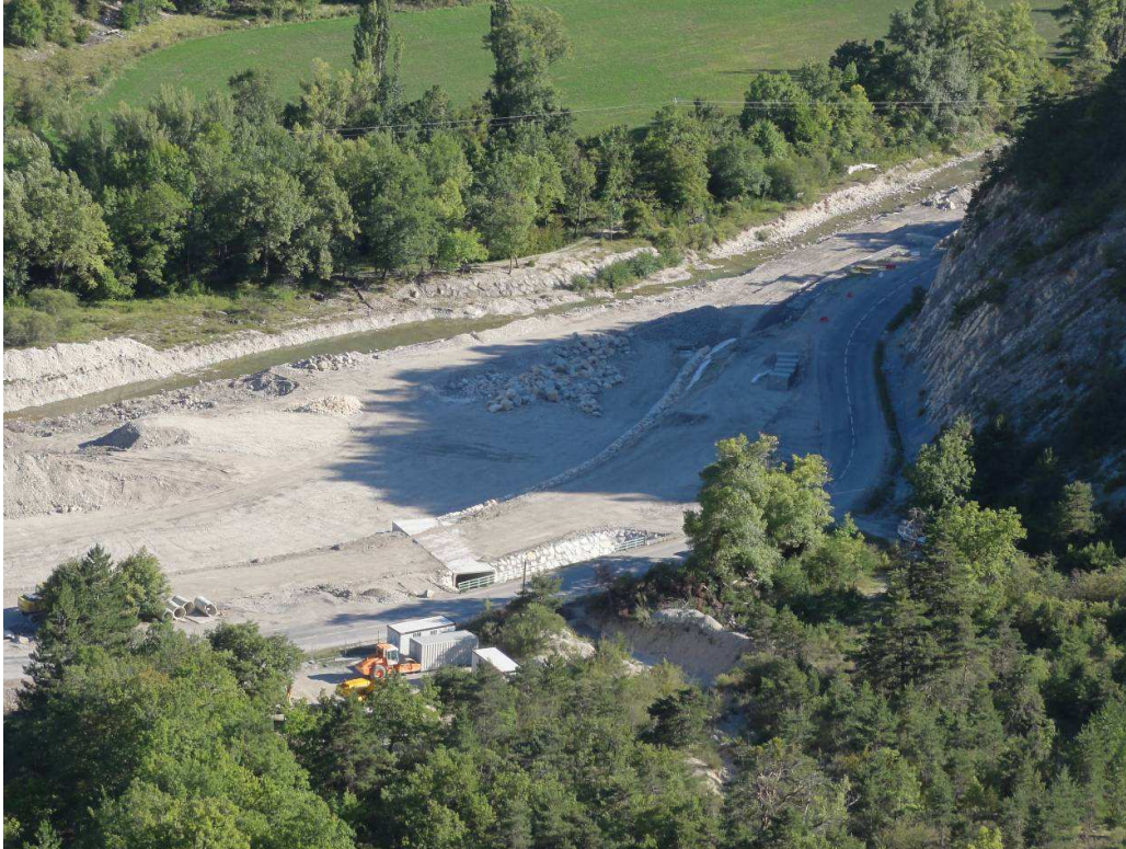
Photo 1 : Travaux de la déviation de la route D61 ; nous voyons l'ancienne route qui passait près de la coupe géologique du Serre de l'Âne et le tracé de la nouvelle voie avec le petit pont en construction qui enjambe le torrent de la combe Reboul ; en arrière plan, la rivière l'Oule - @ S. Reboulet (= @SR).
