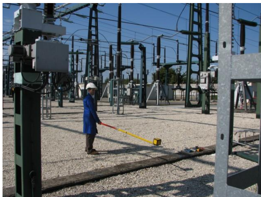
Figure A : mesure d'un champ électrique à l'aide d'une perche tenue à la main
