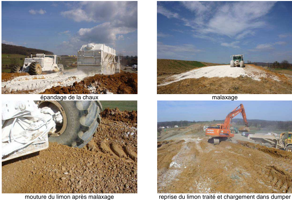
Figure 3 : atelier de traitement du limon
