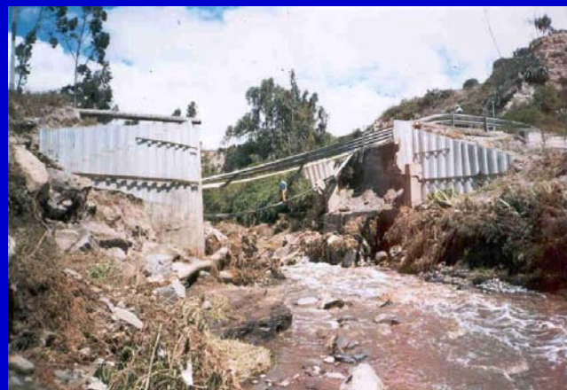
Dstrucción del puente de acceso a la urbanización La Pampa 2001 (foto F.Demoraes)
