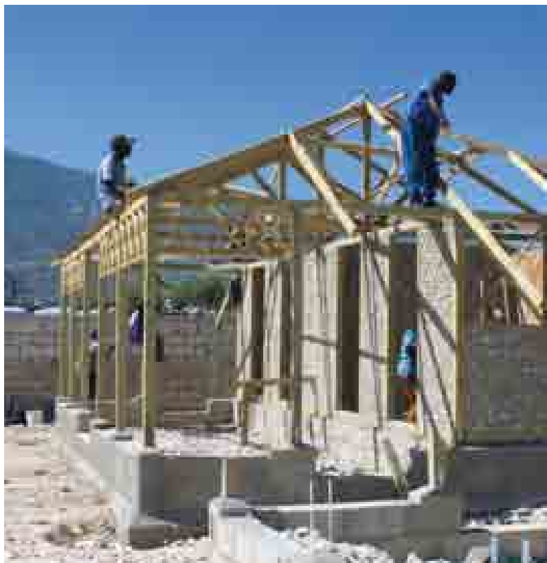
Ci-contre, remplissage en débris maçonnés des panneaux de mur en ossature bois
