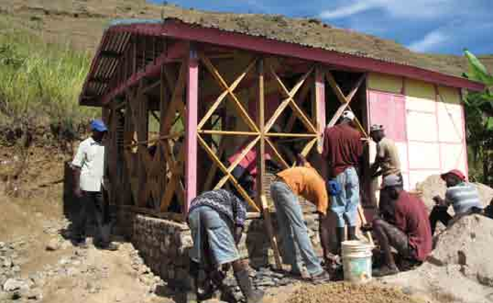
Ci-dessus, chantier formation à Belle Fleur, sur une maison à ossature bois et remplissages ti-woch et briques crues
