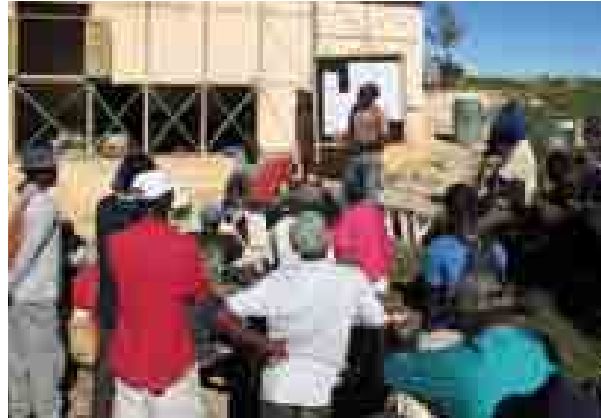
Les ingénieurs haïtiens, impliqués depuis le début du programme, dispensent, si nécessaire, des formations sur chantier
