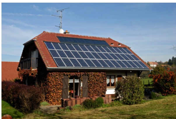
FIGURE 24 – Installation photovoltaïque chez particulier (Source : Wikipedia, article sur le panneau solaire)
