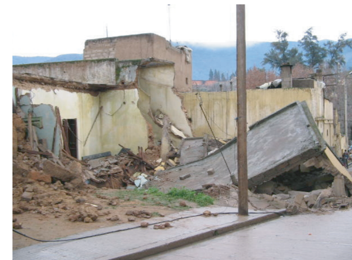
Effondrements karstiques dans la cité Day de Beni Mellal (09-02-2007)
