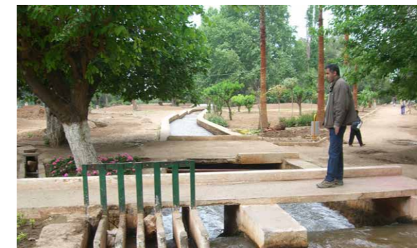
Peigne répartiteur d'eau dans les séguias
