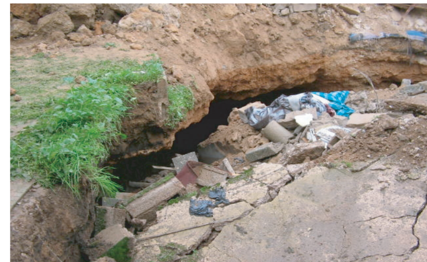
Effondrements karstiques dans la cité Day de Beni Mellal (09-02-2007)
