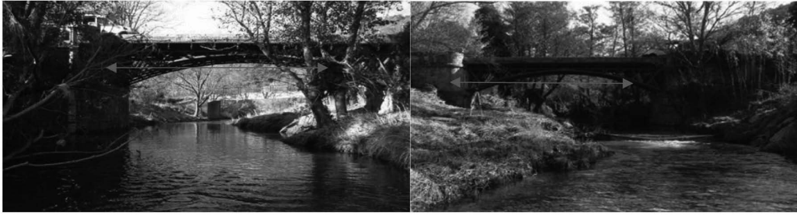
Figure 3 : Photo à gauche prise en amont du Pont de Fer ( à gauche l'échelle limnimétrique) , à droite photo du Pont de Fer depuis l'aval avec le seuil. Les flèches rouges montrent la cote maximum atteinte par l'écoulement lors de la crue.
