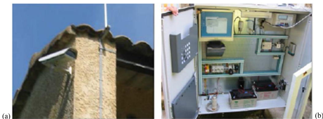
Figure 4 : Equipement de la station fixe de mesure LSPIV sur l'Ardèche à Sauze. (a) caméra analogique (b) caisson étanche contenant l'ordinateur et le modem.
