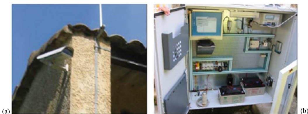
Figure 4 : Equipement de la station fixe de mesure LSPIV sur l'Ardèche à Sauze. (a) caméra analogique (b) caisson étanche contenant l'ordinateur et le modem.
