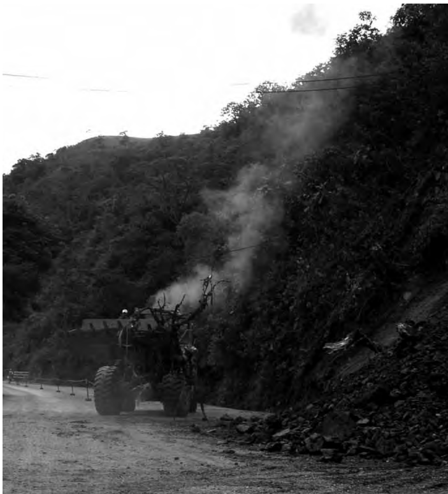
FIG. 12. Uramita, Antioquia (abril de 2008). Derrumbe en la carretera al Mar. Fuente: Fotografía del autor
