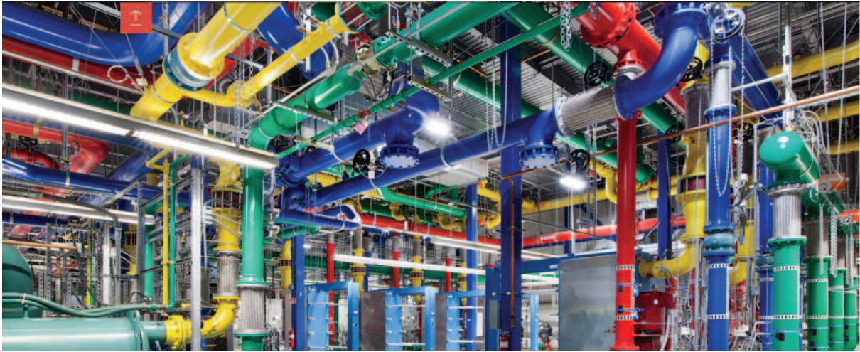
Refroidissement du datacentre de Google à The Dalles, Oregon
