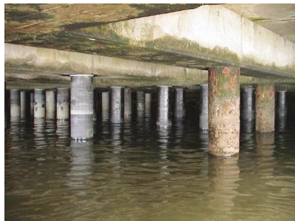
b) Etat de corrosion
