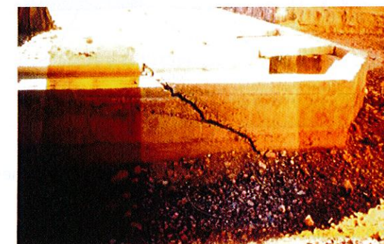
figure 15 Fissures dans une dalle (Ejjaouani, 2008).
