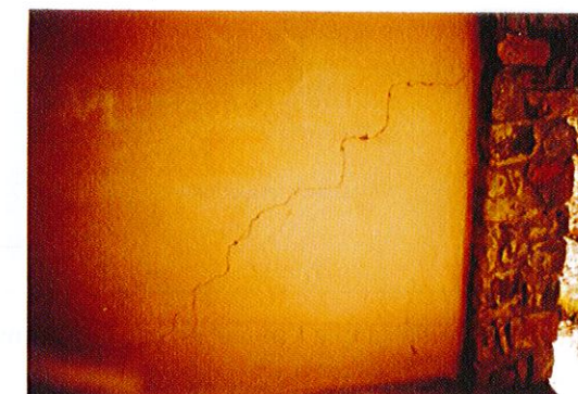
figure 14 Fissures dans un mur (Ejjaouani, 2008).
