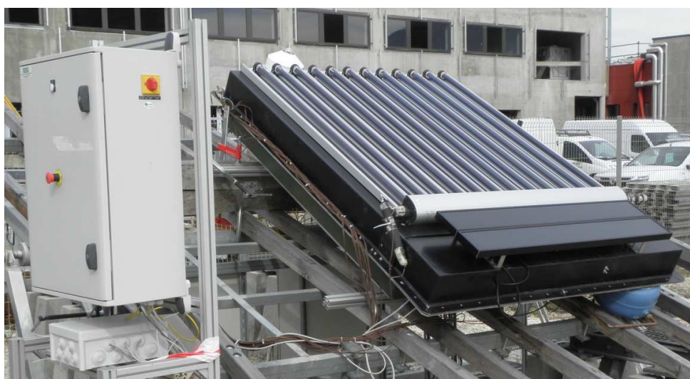
Figure 20 : Le prototype installé en environnement extérieur
