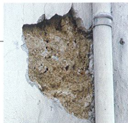
←↑ Le pisé apparaît sous l'enduit dégradé au N°34
