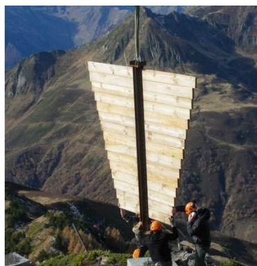
Figure 6. RTM du Capet, pose d'un panneau vire-vent à tablier tenu et porté par un poteau unique (ONF_RT M 64-65).
