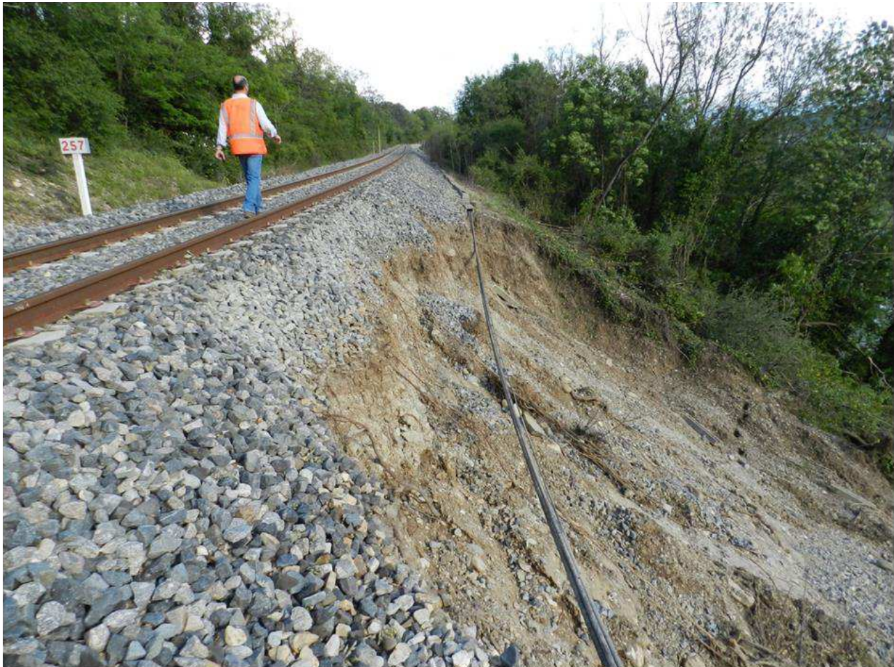
Figure 9. Glissement d'environ 5 000 m 3 du remblai de la voie ferrée au sud de Serres, constaté le 24 mai 2012 à 18h30 (photo © Patrice Mériaux, Irstea, 26 mai 2012).
