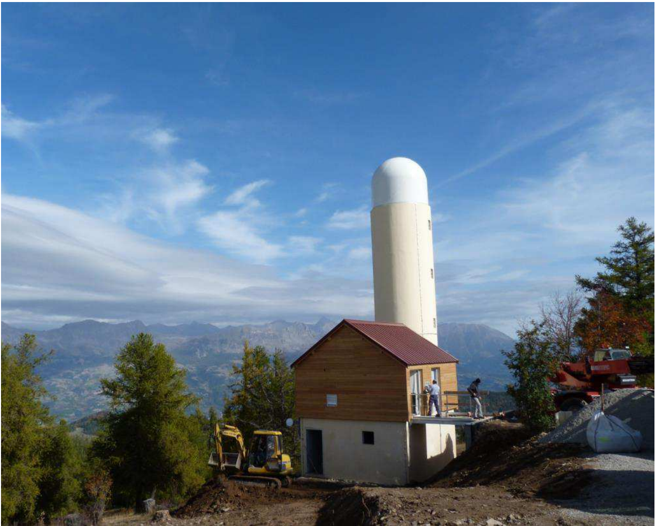
Figure 2. Installation radar au sommet du mont Colombis à 1742 m (altitude du faisceau radar), sur la commune de Théus dans les Hautes-Alpes. ©Météo-France, Yves Clémenceau.
