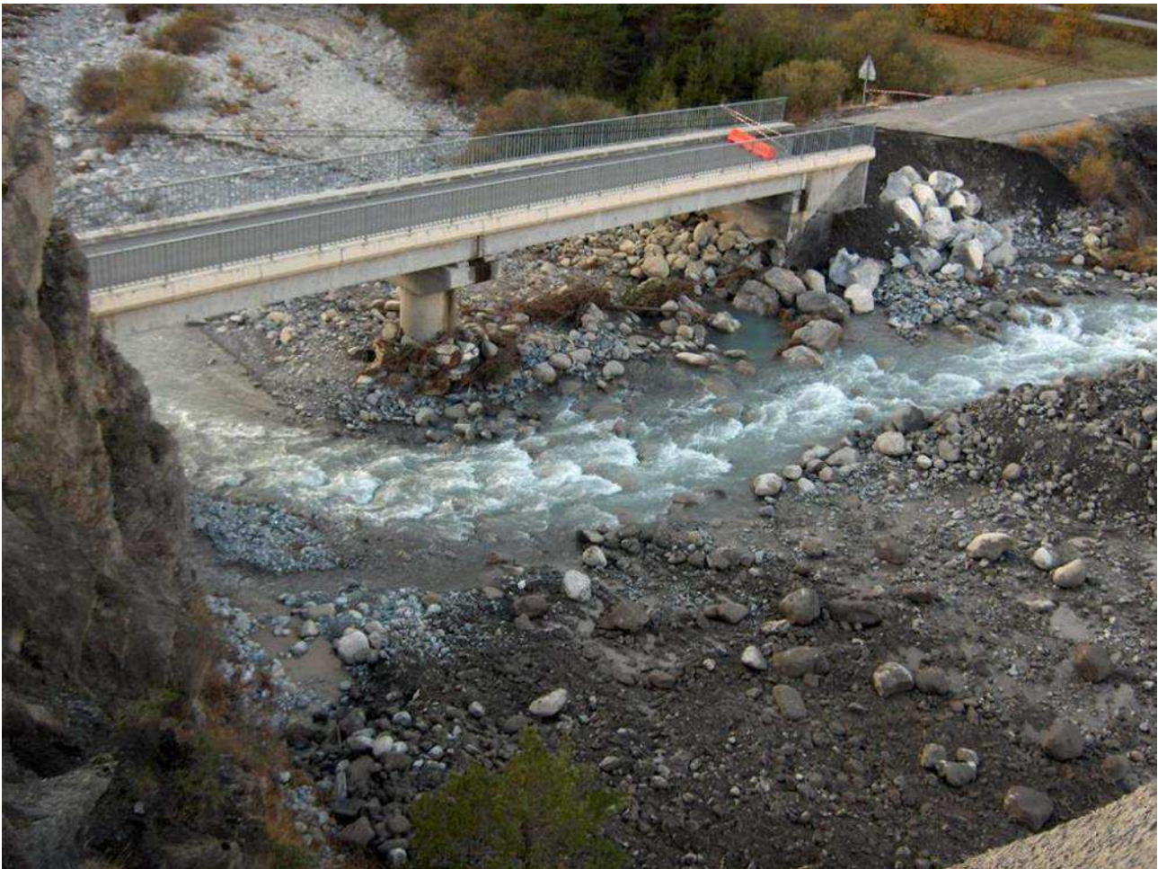
Figure 12. Passerelle contournée sur la Bléone à Prads, après la crue torrentielle des 4 et 5 novembre 2012 (photo© Jean-Yves Sabinen, Onema, 06/11/2012).
