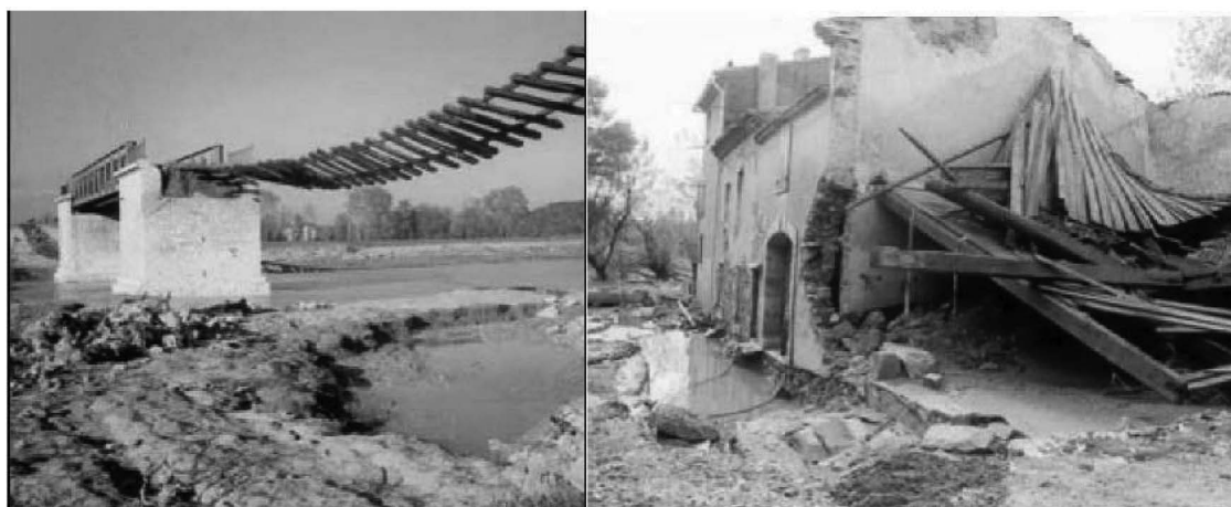
Figure 7 : Crues du 12 et 13 novembre 1999 sur le bassin versant de l'Aude : (a) remblai de la voie ferrée emporté par la crue de l'Aude à Sallèle ; (b) maison à Luc-sur-Orbieu après le passage de la crue de l'Orbieu (source : EGIS Eau, rapport AZI).
