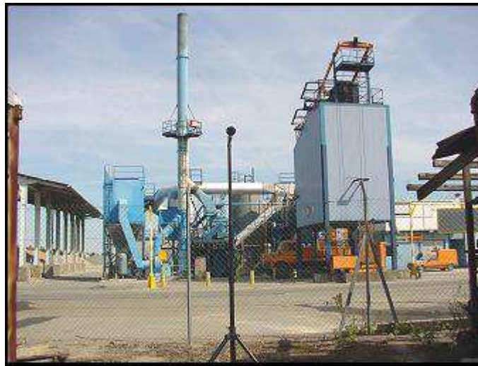
Figure 4 - 19. localisation des points de mesure à la centrale d'enrobage
