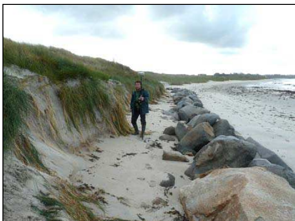
Photo 1. Falaise d'érosion et recul de la dune à l'arrière de l'enrochement de la plage du Curnic (Vougot) – 18/10/2012
