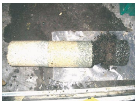
figure 1 Désordres dans la chaussée du nord-est de la France a : Carotte de la structure de chaussée b : Chapelets de nids de poule pluridécimétriques
