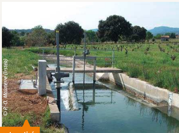
③ Ouvrage automatisé sur le canal de Gignac.
