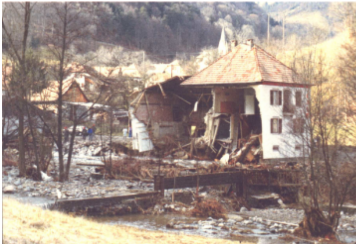
Habitation détruite à Linthal en février 1990 (Source : PPRI Lauch)
