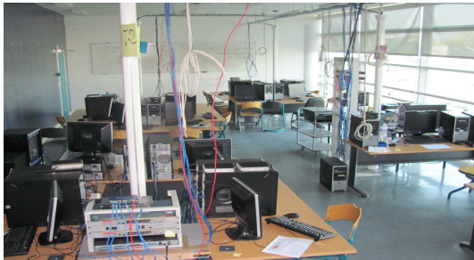
Fig 1: Vue de la salle réseau
