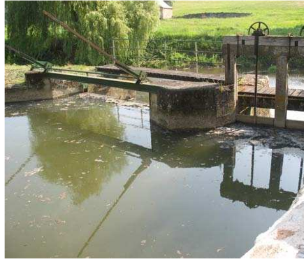
Clapet basculant (à gauche) et crémaillère (à droite) sur le site du moulin de Thévalles
