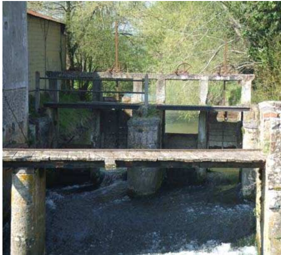
Moulin de la Vove, barrage délabré partiellement ouvert (avril 2010)
