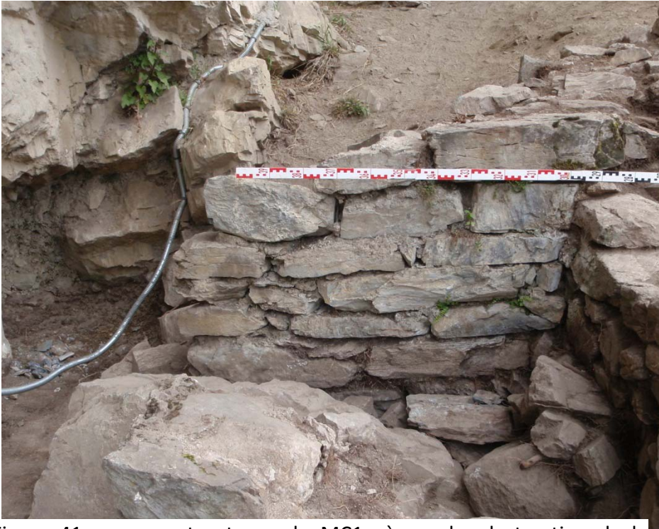
Figure 41 : parement externe du MC1 ; à gauche destruction de la fouille clandestine, à droite MC4.
