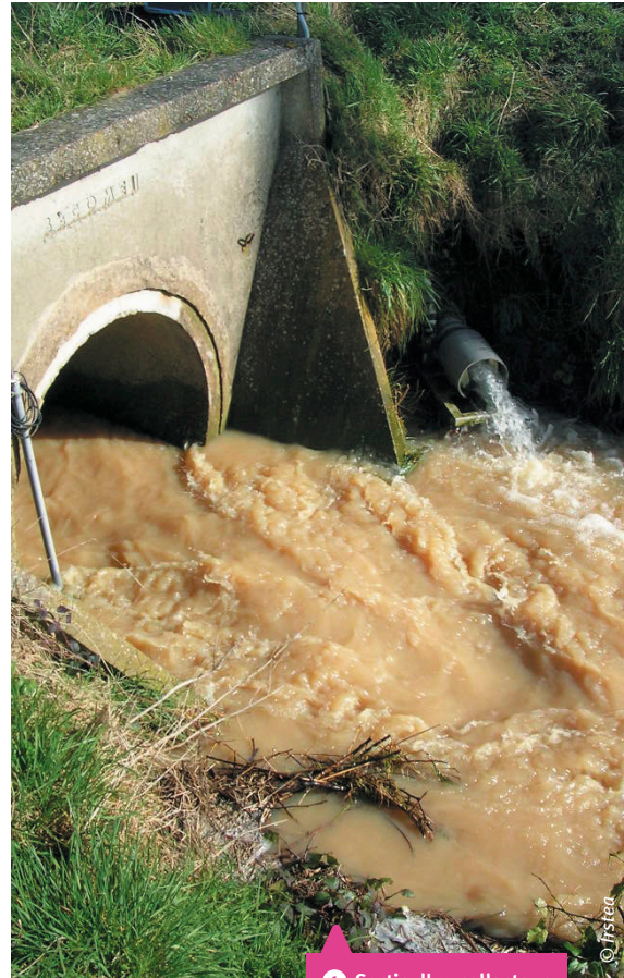
1 Sortie d'un collecteur enterré à Mélarchez.
