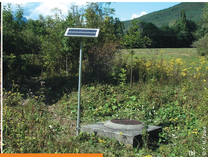
1 Regard 1 : débitmètre à auget mis en place (a) et panneau solaire extérieur (b).
