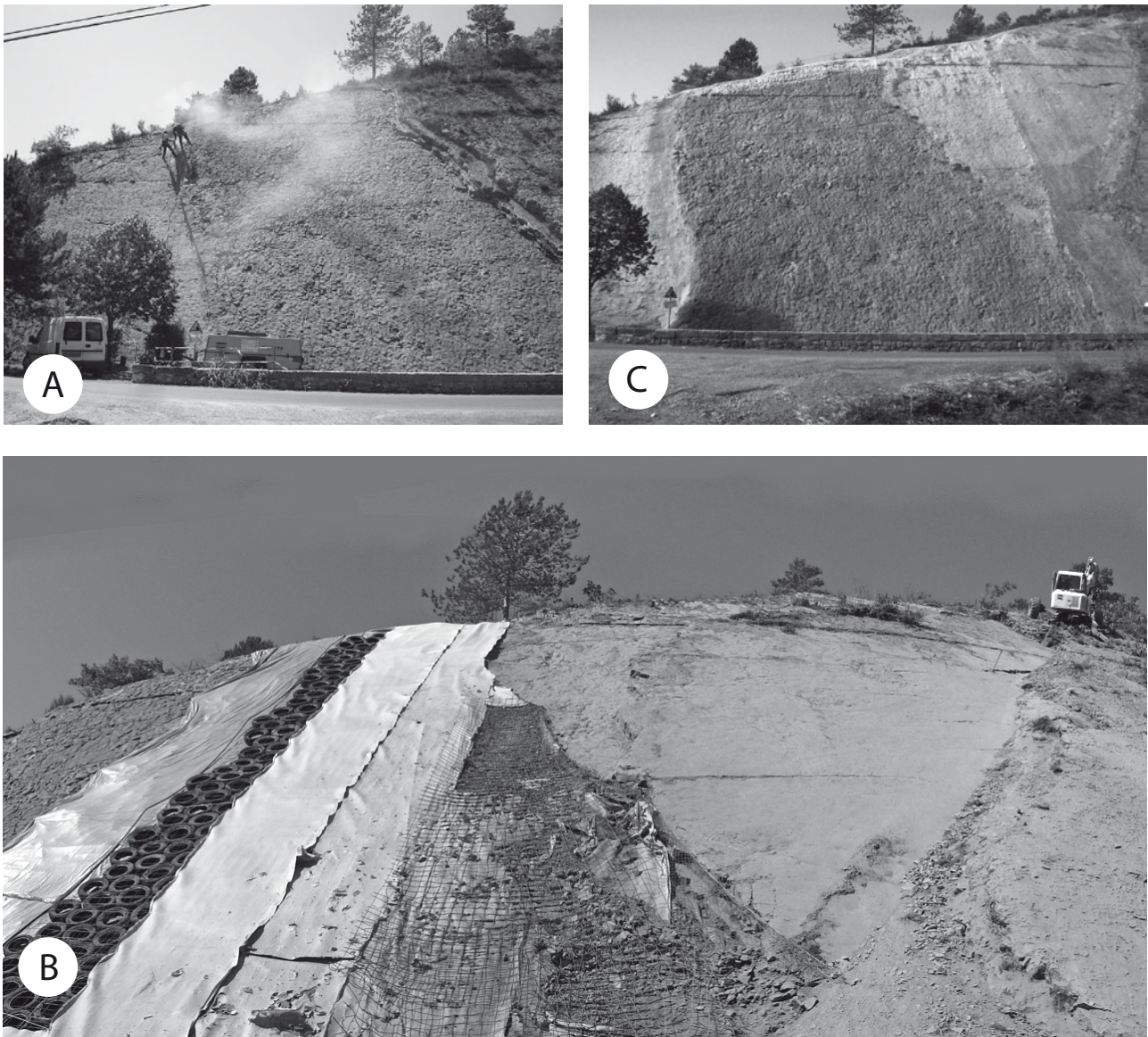
Fig. 5: Le chantier de sécurisation, de conservation et de mise en valeur de la «Dalle» en 2009. A. Le début du chantier en 2009 (Photo M. GUIOMAR). B. Vue panoramique du chantier (photo J. BOURIDEYS). Sur la gauche, des protections recouvrent les ammonites et sur la droite une pelle-araignée effectue le déroctage des surplombs. C. Le site de la «Dalle à ammonites» à l'issue du chantier de 2009.
