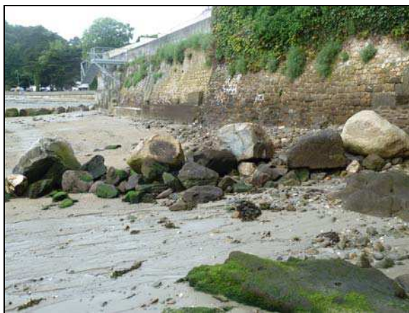
Photo n° 10: ajout inutile de blocs disjoints sur l'épi n° 2 au printemps 2012
