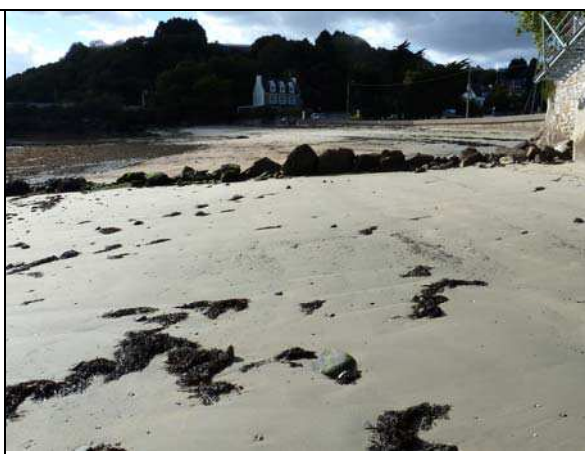
Photo n° 7 : L'épi n° 1 le 28 octobre 2011. Noter les seuils, l'irrégularité de la cote d'arase. De plus l'angle de la photo masque une partie des défauts de ce type.
