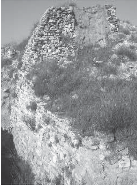
Fig. 5. El Coll del Moro de Gandesa visto desde el sur (foto del autor). Se aprecia el grosor del muro y su paramento exterior ataludado. En el primer plano, base del paramento en un sondeo profundo (punto A en el plano de la fig. 2).
