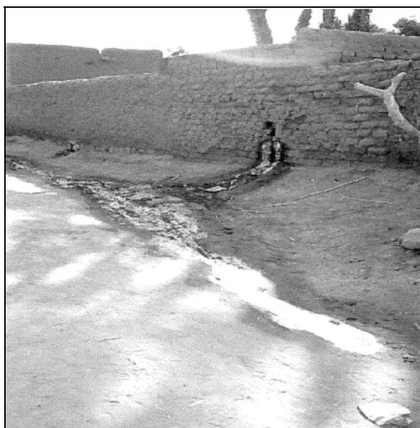
Cliché 22. Douchière se déversant dans la rue (cliché Bouju, 1998)
