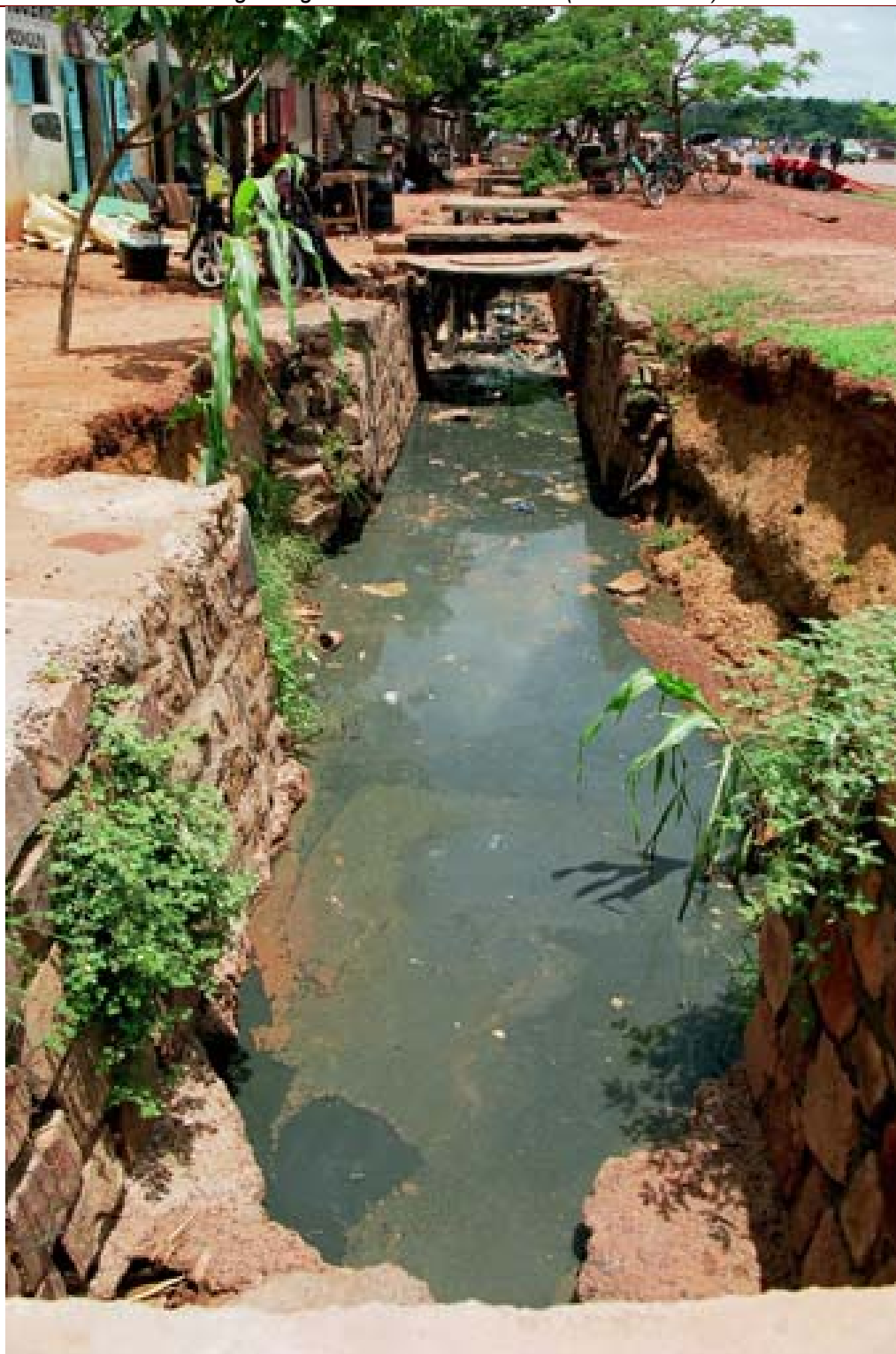
Cliché 19. Les produits détergents que les teinturiers utilisent attaquent la vieille maçonnerie du canal d'évacuation des eaux pluviales qui s'effondre progressivement (cliché Bouju, 2001)
