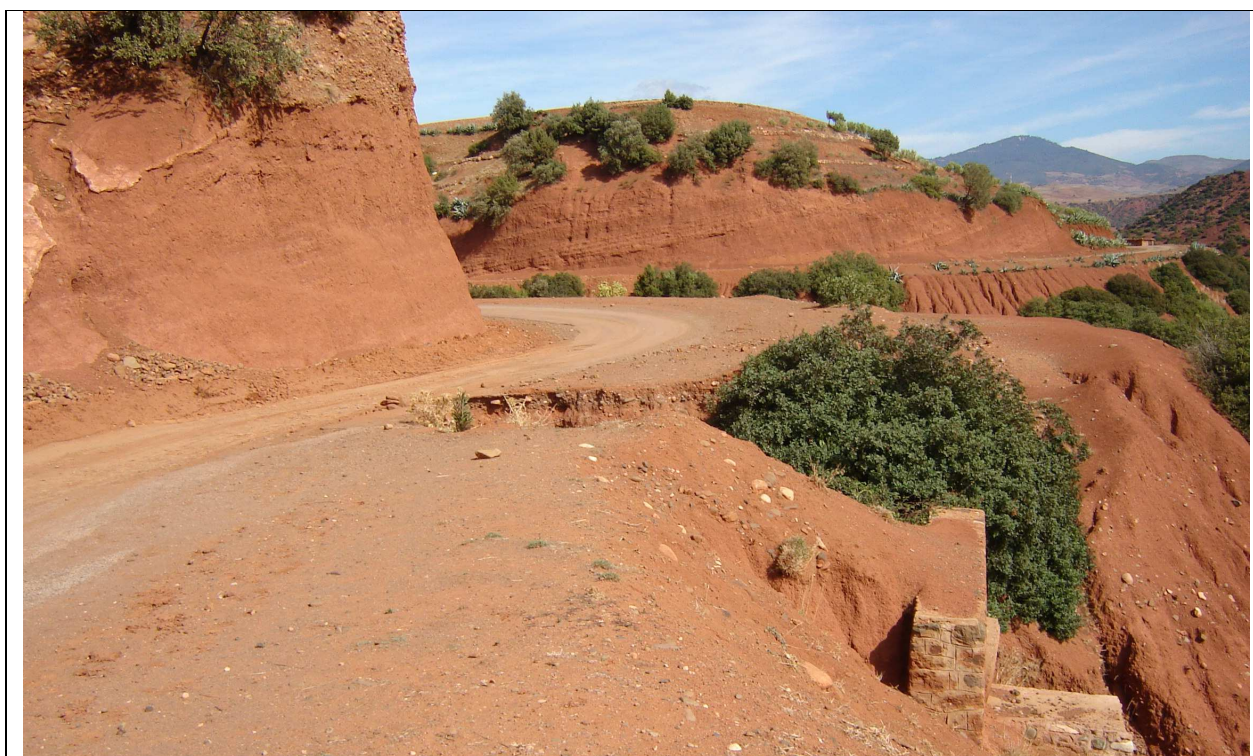
Photo 3 : Vue vers l'Est. La seule route qui longe la vallée du Srou est partout entaillée en raison de l'extrême vulnérabilité des terrains argileux au ruissellement, comme ici à 8 km au sud-ouest de Kerrouchène. Bien qu'elle soit goudronnée, la route revêt la couleur ocre de l'argile (cliché de l'auteur, 6 novembre 2005).
