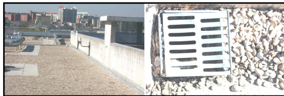
Crapaudines en amont des descentes de gouttières, au niveau de la toiture terrasse gravillonnaire.
