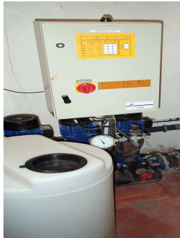
Chloration et armoire contrôle
