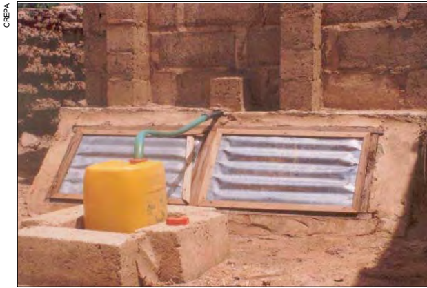
Figure 13 : lieu de stockage des urines d'une toilette ECOSAN à double cuve
