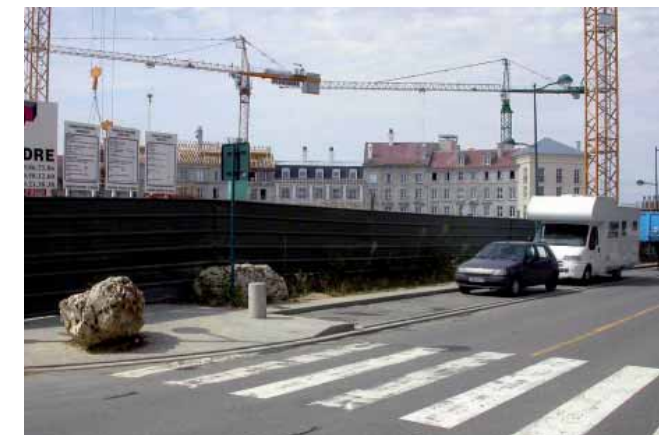
La place de Toscane en construction, depuis le cours de la Garonne, juillet 2005.
