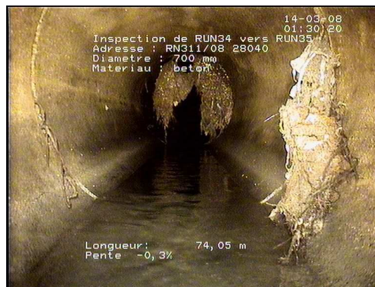
Figure 25 : Système racinaire pénétrant dans une conduite d'assainissement.
