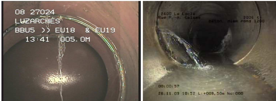
Figure 24 : Infiltration d'eau claire parasite permanente (ECPP) dans un réseau d'assainissement.
