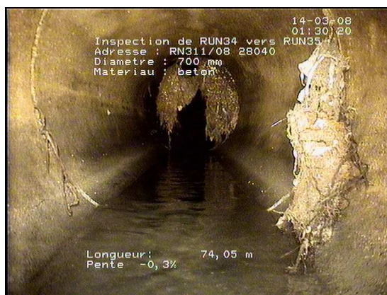
Figure 25 : Système racinaire pénétrant dans une conduite d'assainissement.
