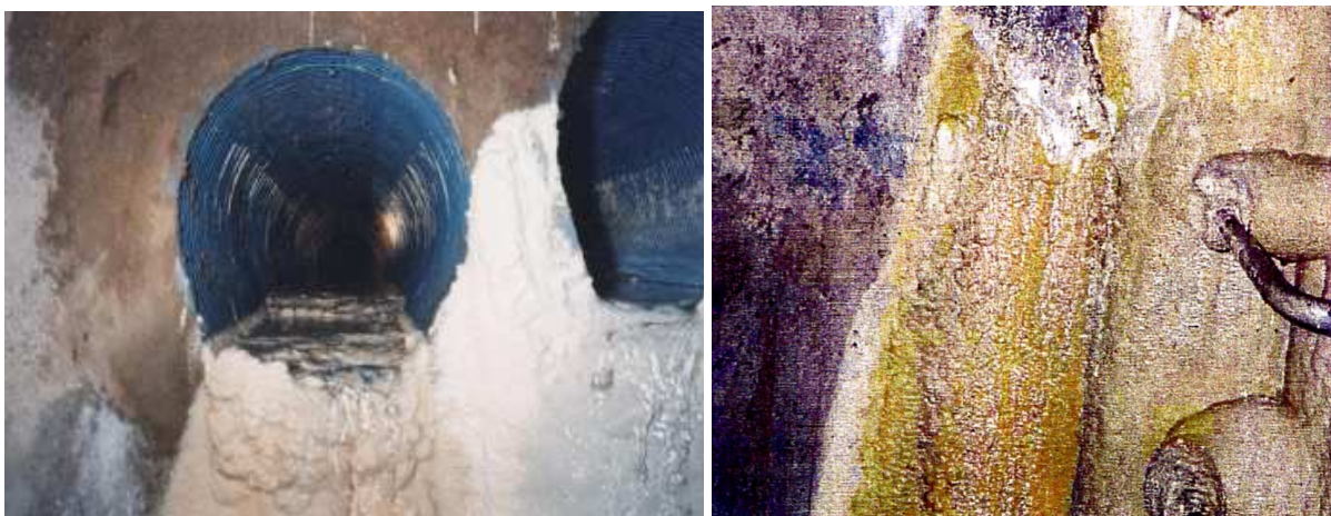
Figure 11 : Photographie de drains en voie de colmatage sous la chaussée drainante de l'A86 ; dépôt de calcite sur l'échelle d'accès.
