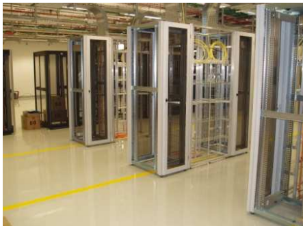
Figure 18 : Salles des baies informatiques
