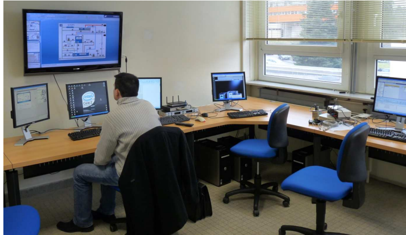
Figure 4 : Salle de commande
